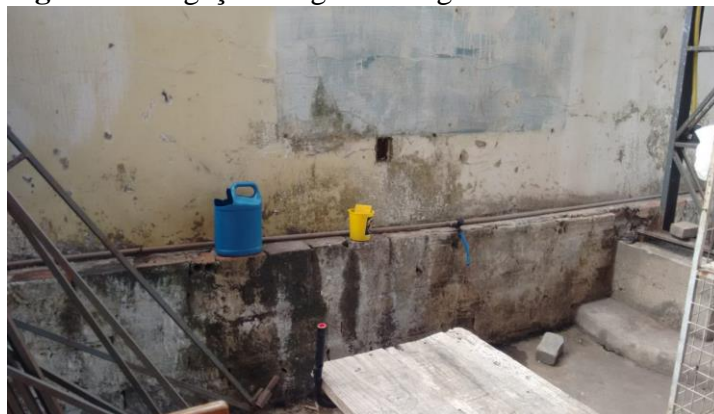
Figura 4 – Ligação irregular de água da sede 2
