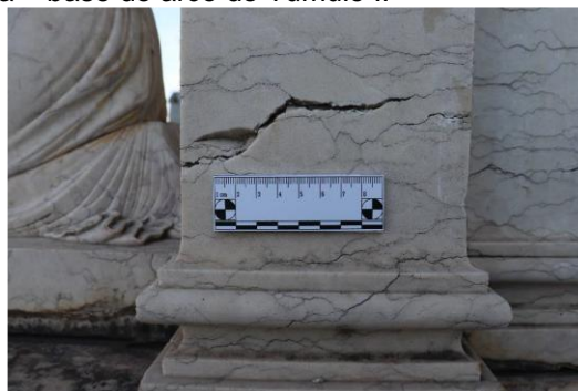
Figura 2 – Fratura com perda – base do arco do Túmulo I.
